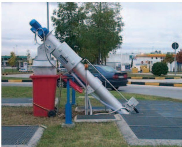
ROTAMAT® Micro Strainer instalado en medio de una rotonda
