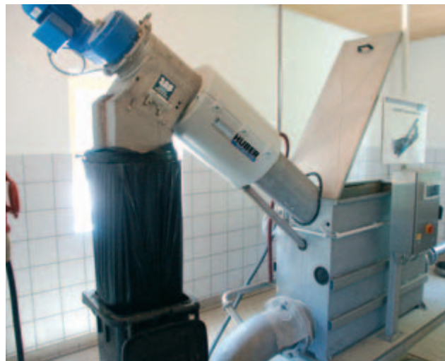
ROTAMAT® Micro Strainer instalado en contenedor
