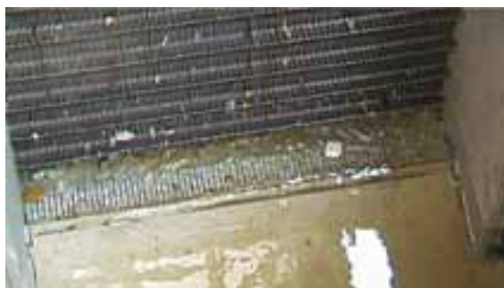
Ejemplo de un tamiz instalado en canal de manera que los residuos se elevan desde el fondo del canal.
