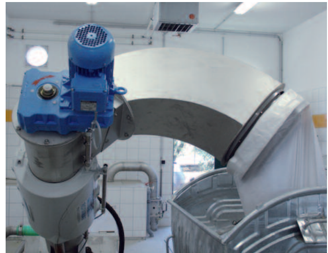
Instalación especialmente adaptada para descarga lateral del material removido directamente a un contenedor.
