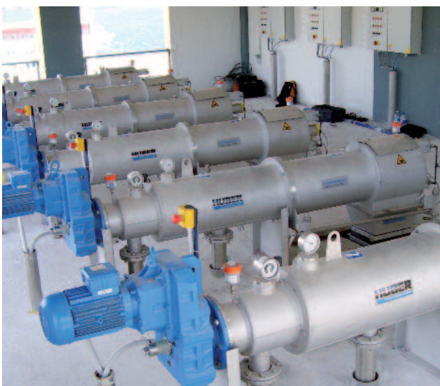
Tamizado de lodo en la Planta de tratamiento de aguas Barcelona, España
