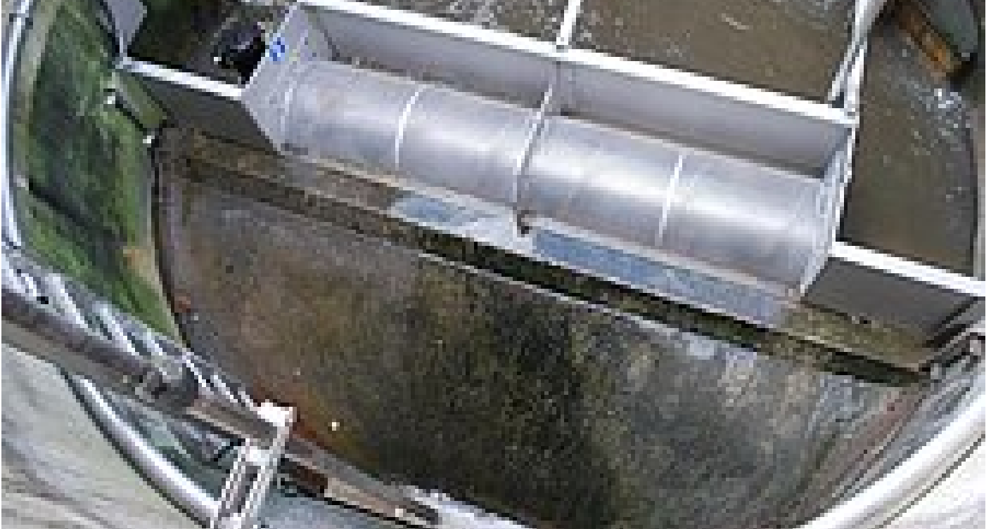
Planta de cribado HUBER ROTAMAT® RoK2 en una estructura de aliviadero
