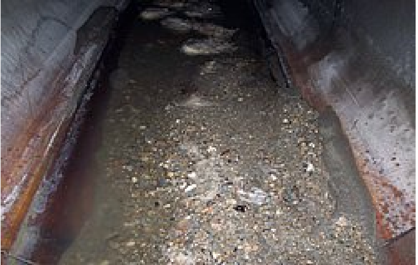
Depósitos en el canal de agua mezclada después de un período de sequía más prolongado
