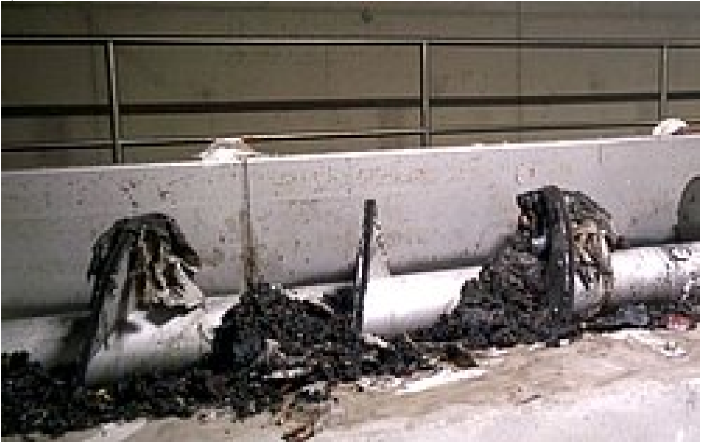
Aumento de las cantidades del material retenido por la rejilla en los aliviaderos de agua mezclada
