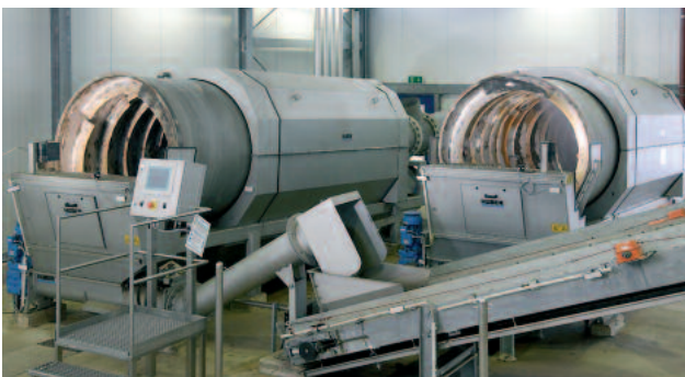
Planta de recepción de fangos con ROTAMAT® RoFAS.
