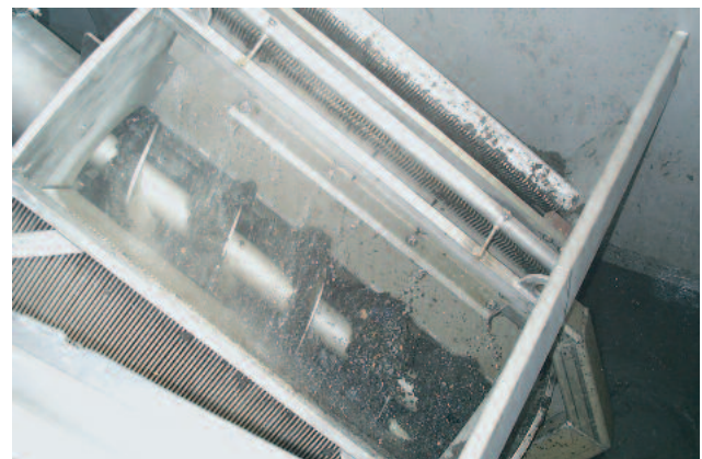
El material flotante es retenido en el interior de la malla. Los dientes del peine pasan a través de ella y aseguran la limpieza completa de manera automática.
