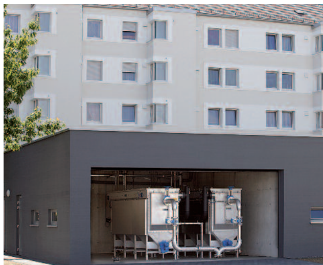
Estación de calor que utiliza el intercambiador de calor HUBER RoWin®.
