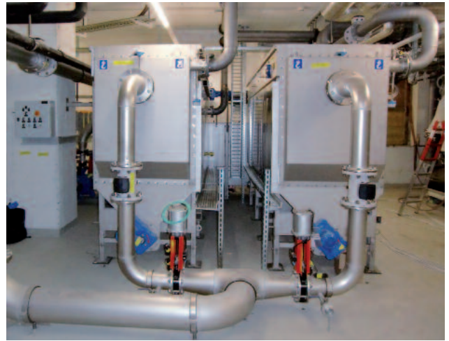
585 kW de calor recuperados, 605 kW de capacidad de enfriamiento, usados para calentar y enfriar 22.000 m 2 de un edificio de oficinas (agua residual urbana).
