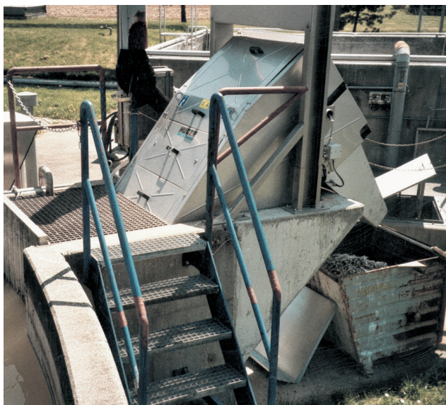
Бумажная фабрика Платтлинг, Германия: очистка от твёрдых и взвешенных веществ при помощи ступенчатой решётки HUBER STEP SCREEN® SSF
